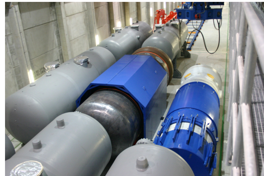
Rechts im Bild: Reaktordruckbehälter (RDB) des KKR in der Halle 7 des ZLN
