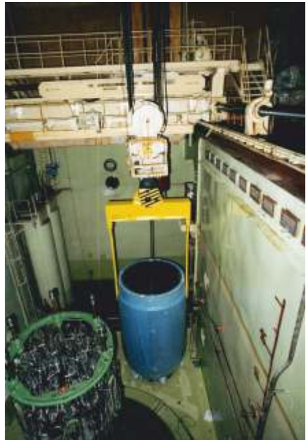
CASTOR 440/84 neben Abklingbecken
