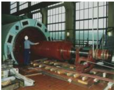
Generator - Ausfahren des Induktors
