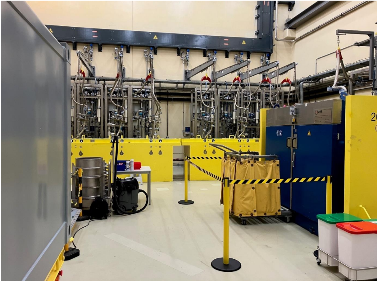
Trocknungsanlage in der ZDW
