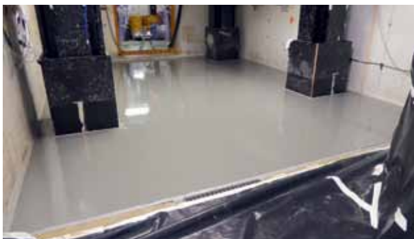
Schwerwassersumpf mit Betonverfüllung und aufgebrachter Dekontaminationsschicht DIDO/Jülich
