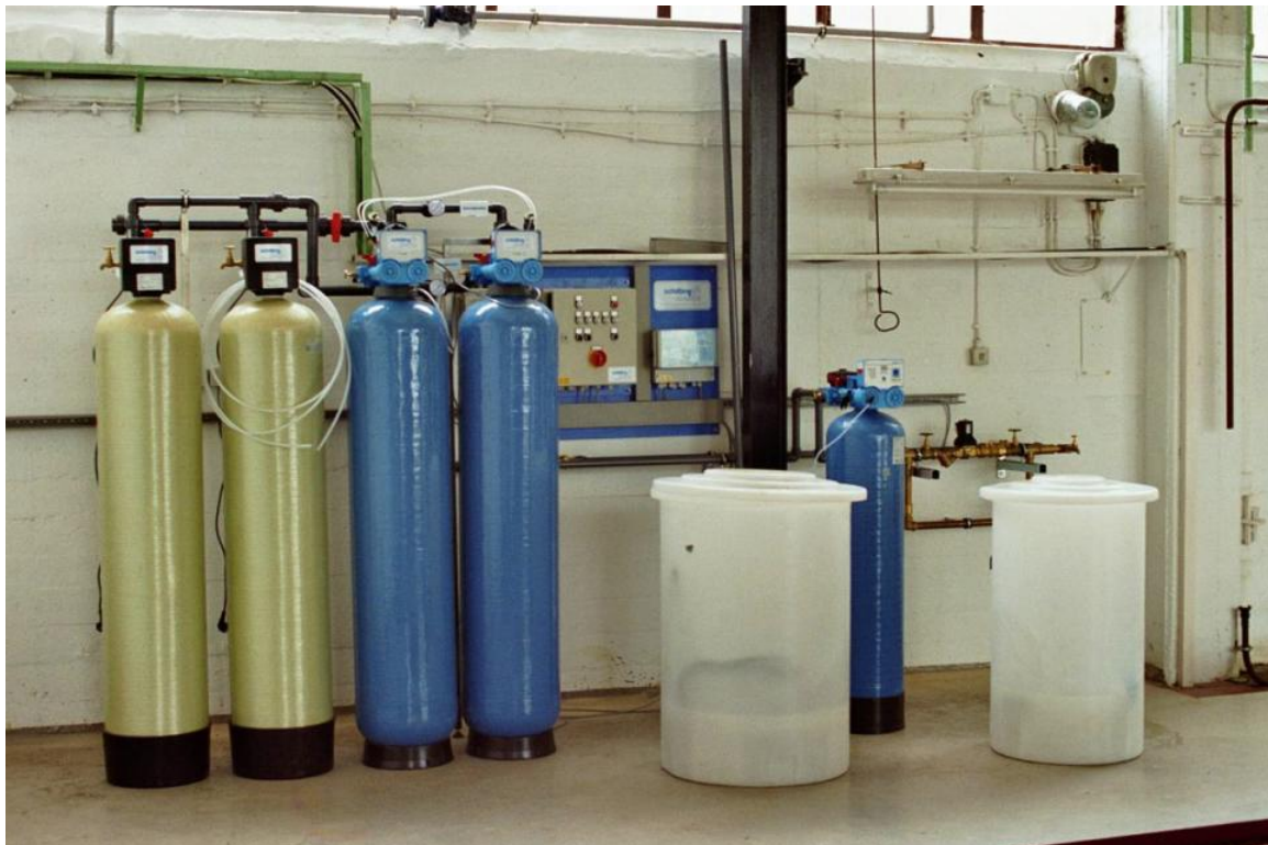
Anlage zur Erzeugung von enthärtetem Wasser
